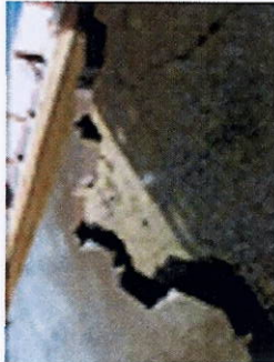
DAMWAND WIJKT VAN BETON (P6)
