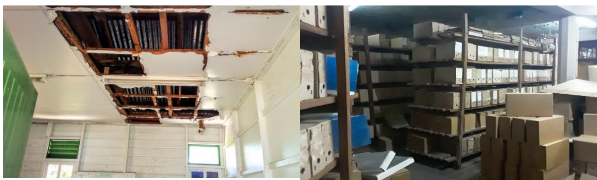
Sommige onderhoudsafdelingen zijn ernstig verwaarloosd op OW; overvolle ruimten/archieven
