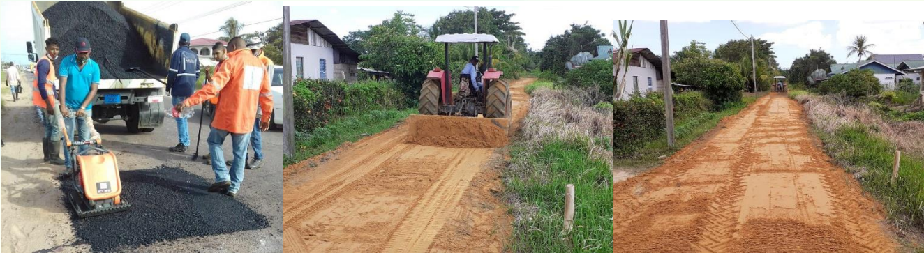
Foto: De toegangsweg van de Jeugd Correctie centrum in het ressort Koewarasan is belegd met base course.
