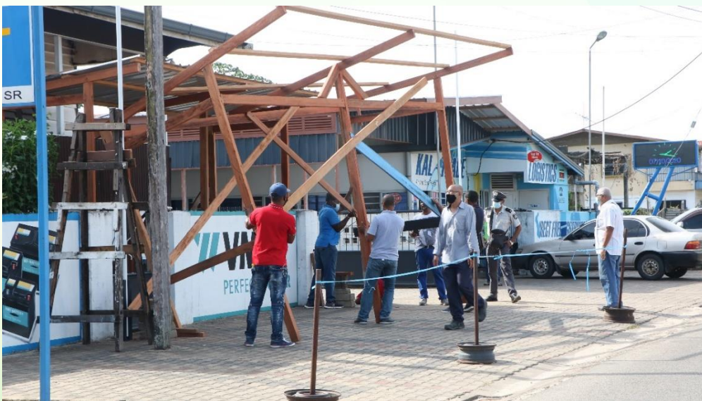
Foto: Bouwwerk verwijderd van berm Indira Gandhiweg
