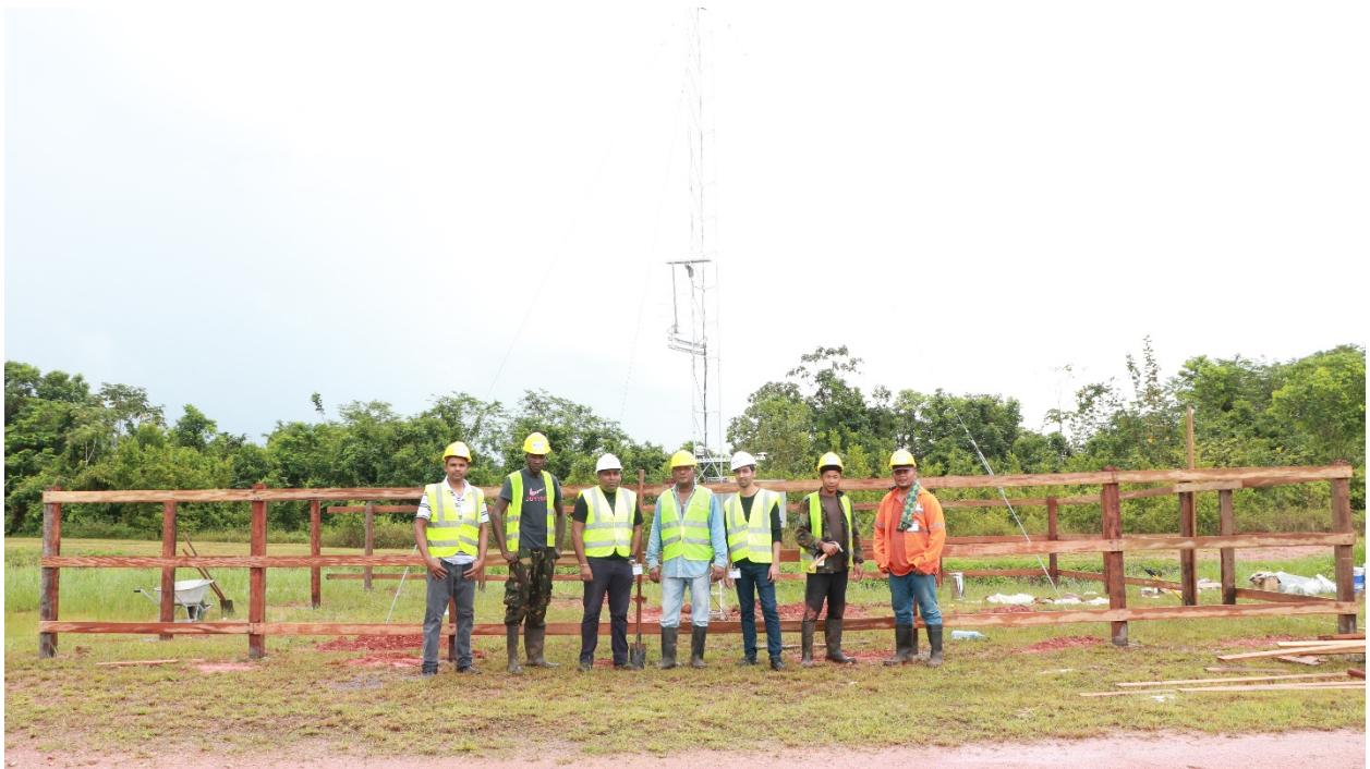
Installatie meetstation te Moengo
