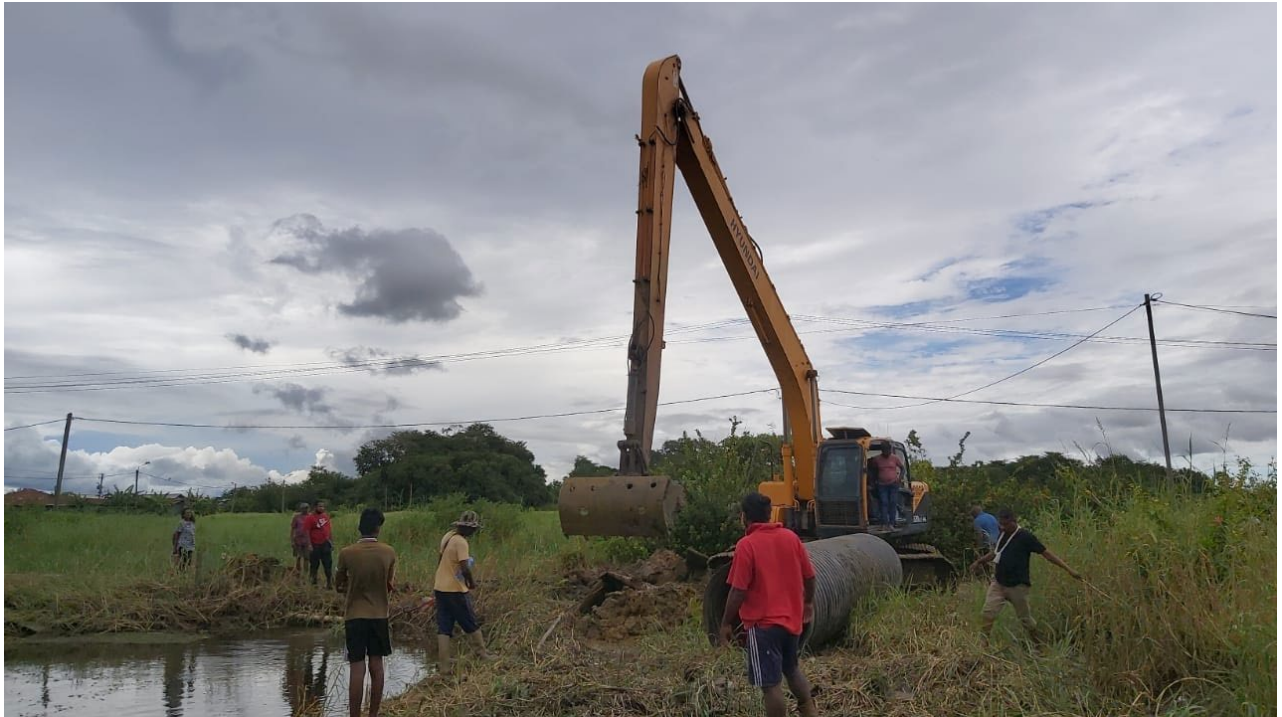
Aanleggen van HTPe buizen aan de Jarbandhanstraat/ zijstraat Tjon A Kiet weg
