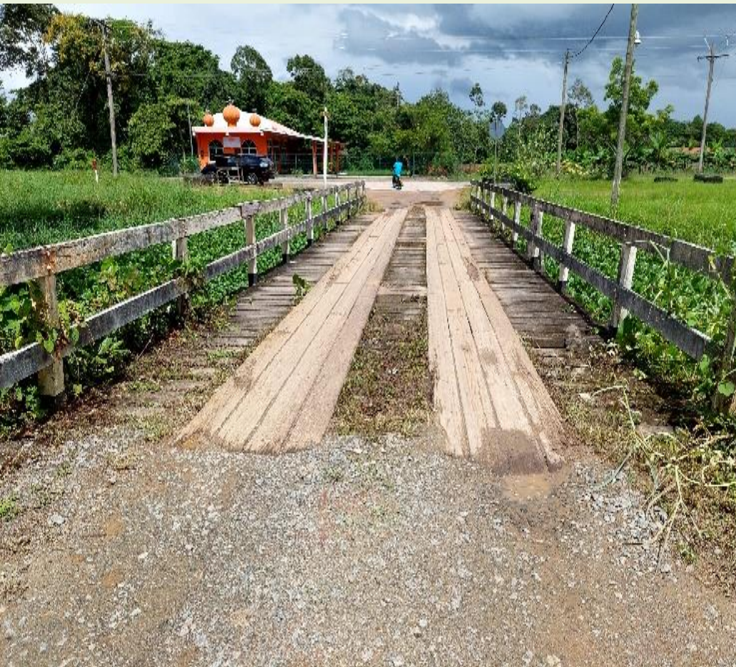
Foto 4 Begroeiing in de kanalen houten brug NW. Libanonweg
