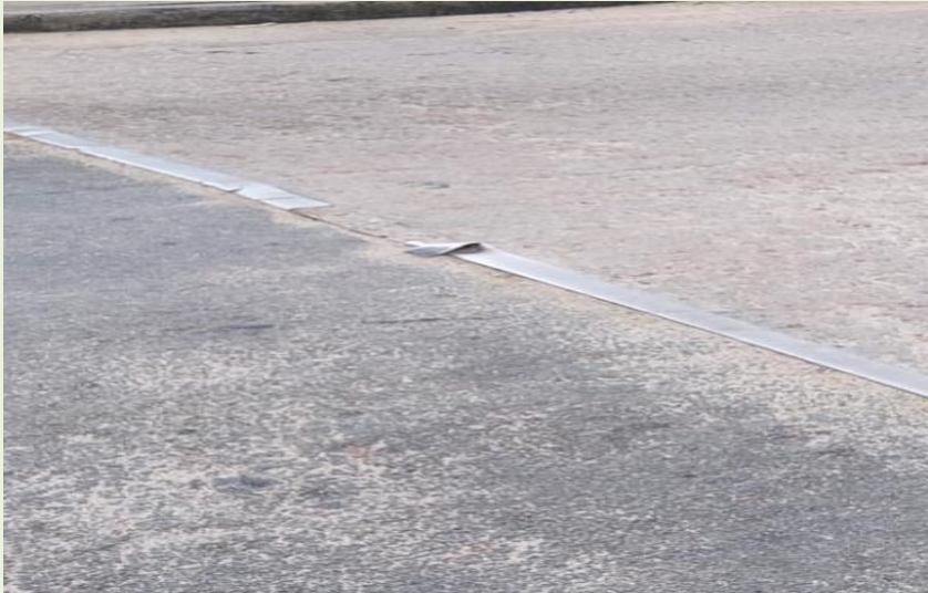
Foto 1 en Foto 2 : Beschadigde stalen hoek profiel brug Commissaris Weythingweg en Leiding 9a
