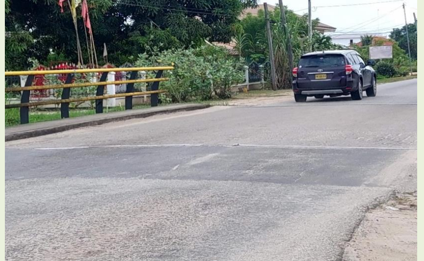
Foto 1 en Foto 2 : Beschadigde stalen hoek profiel brug Commissaris Weythingweg en Leiding 9a
