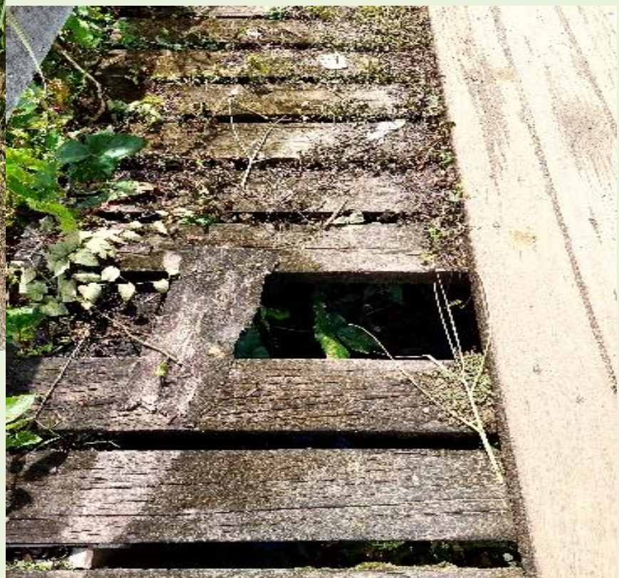
Foto 5 Opening/gat bij de dekplanken houten brug NW.Libanonweg
