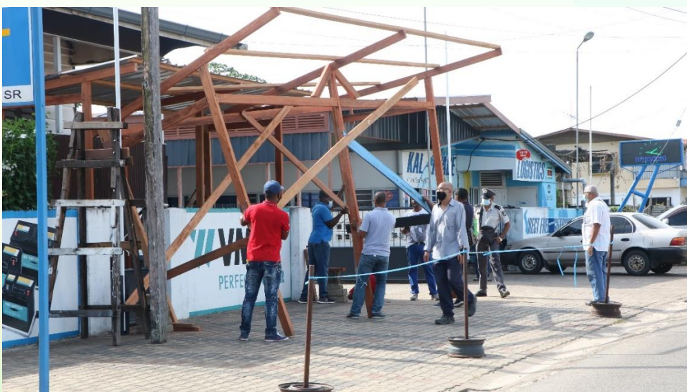
Foto: Bouwwerk verwijderd van berm Indira Gandhiweg
