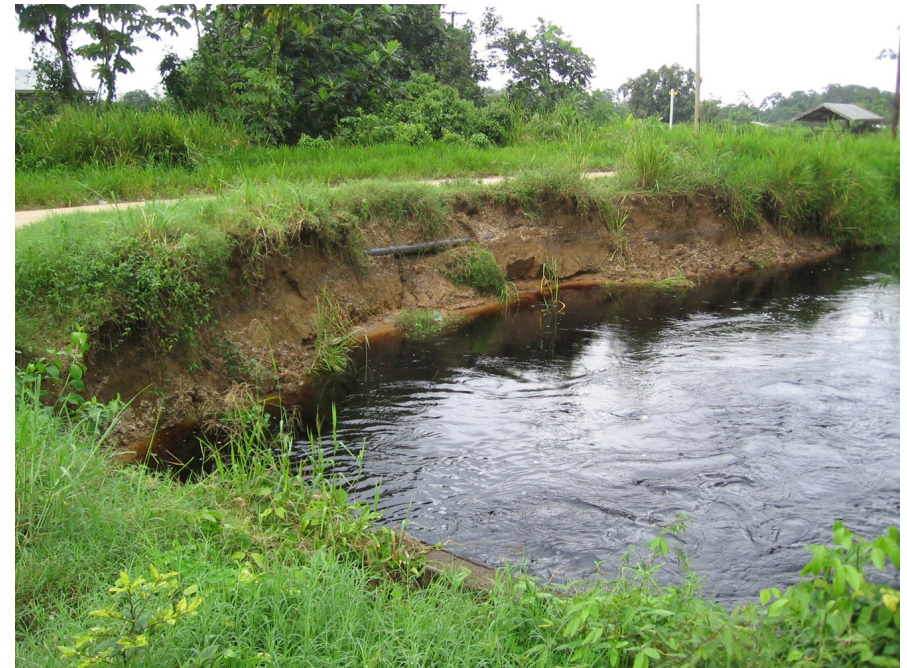
Boven: afkalvende berm
